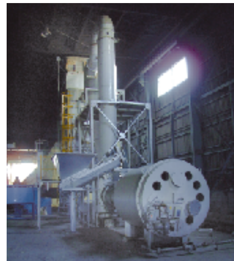
食品残渣リサイクル実証プラント
