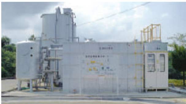
排水処理設備
