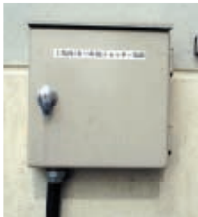
外部操作盤 (内部シャッター)
