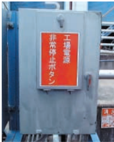
緊急時工場外部 (非常停止ボタン)
