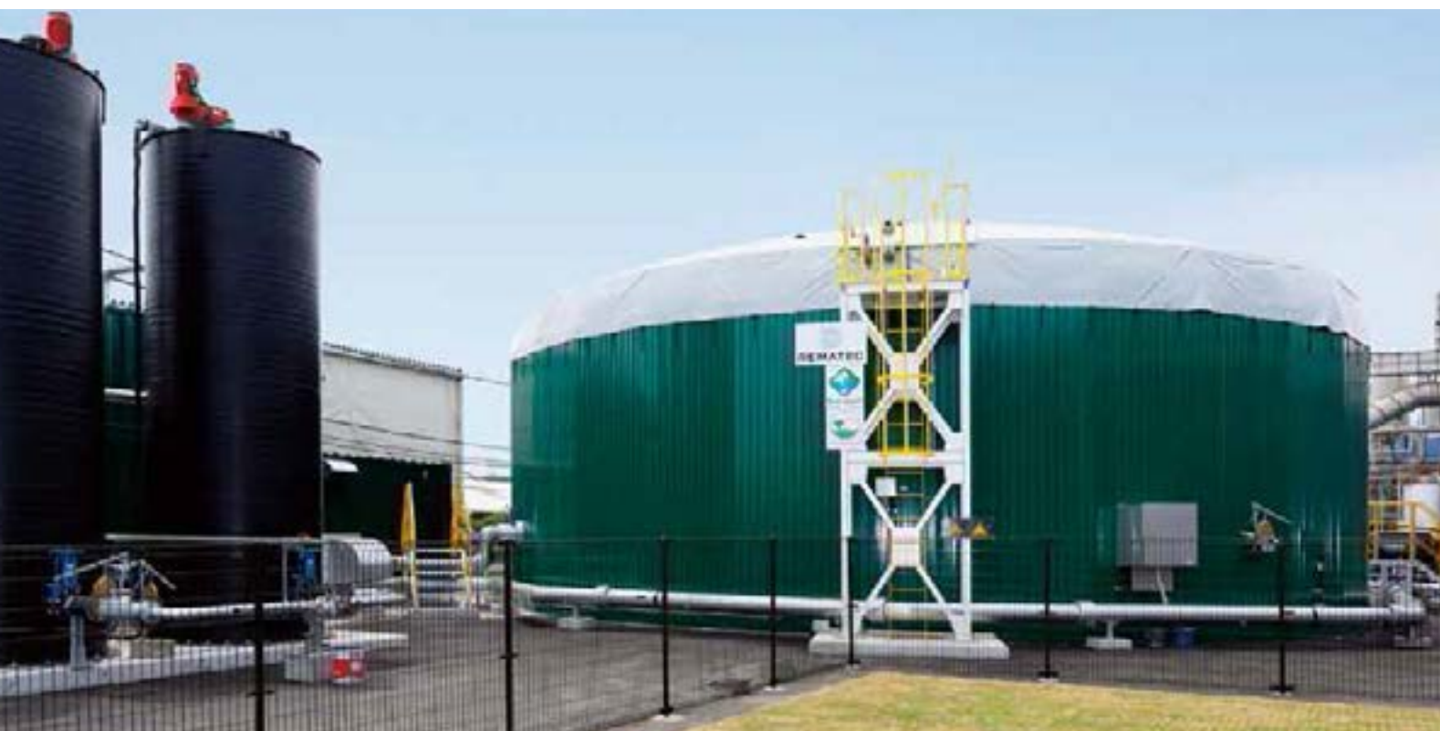
発酵槽全景。2015年3月より発電を開始
