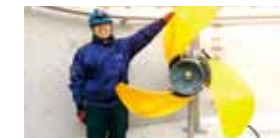
メタン発酵槽内の攪拌機
