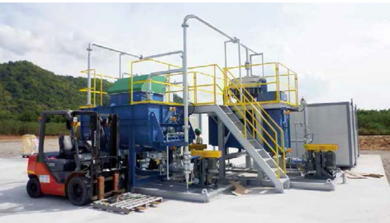
タイ王国のRF実証試験施設
