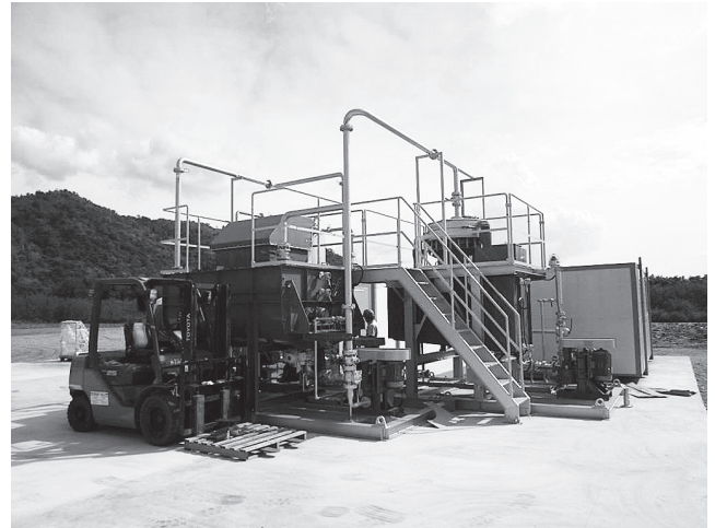
写真3 RF化実証プラント
