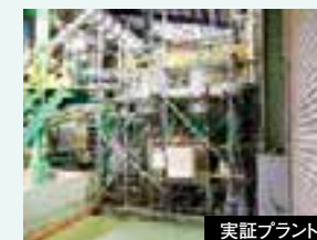
実証プラント
