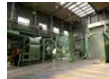
摂津工場 RPF設備
