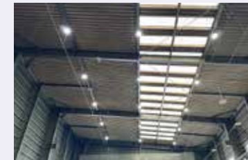
摂津工場LED照明
