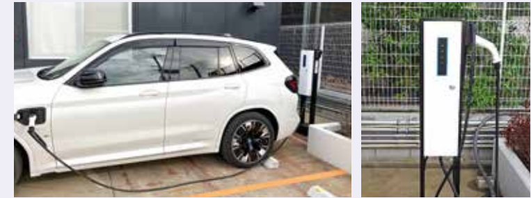
EV車充電状況及び充電設備(出力6.0kw)
